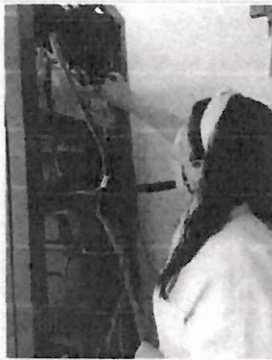
Revisión de conexiones
