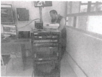
Revisión de conexiones en equipo satelital
