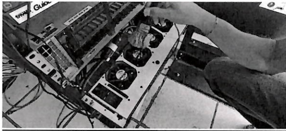
Limpieza a los ventiladores del equipo insertor de tablas
