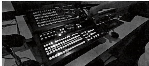
Limpeza a la consola del switcher
