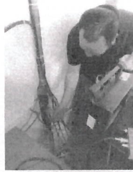
Revisión de conexiones
